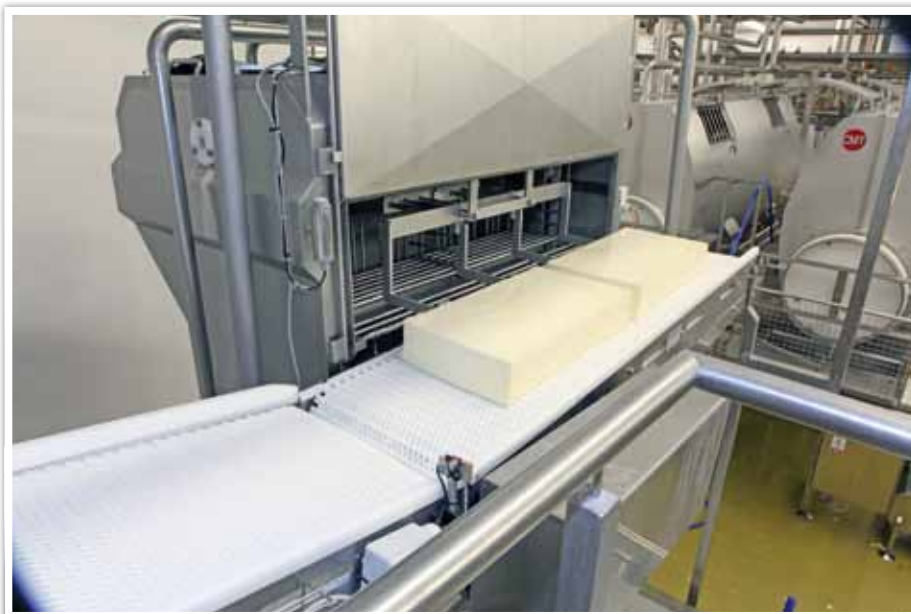
2012 wurde in Jessen eine zweite Erweiterungslinie für die Produktion von Mozzarella Blockware installiert
