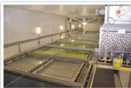
Das Salzbad wurde von Sulbana als Einzelbeckenlösung ausgeführt. Dabei werden die Horden über zwei Manipulatoren chargenweise eingesetzt und wieder ausgeführt (Foto: mi)
